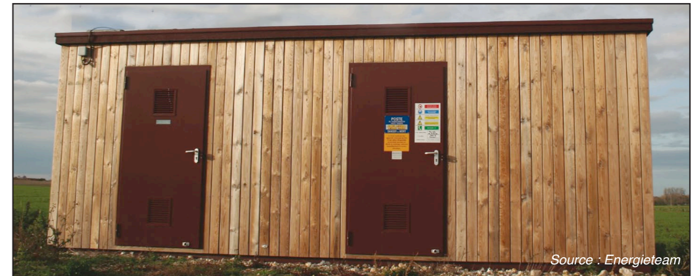
Exemple type de poste de livraison
